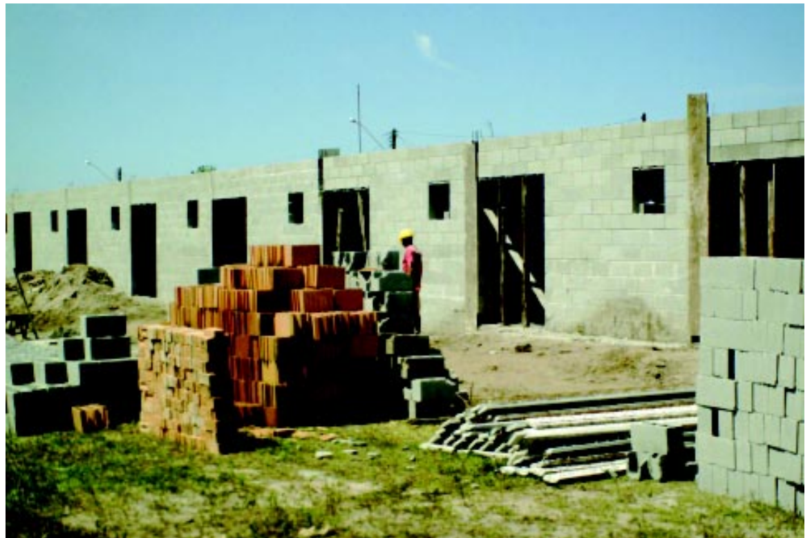
O terreno onde está sendo realizada a construção das habitações foi doado pela Prefeitura. O custo total da obra será de R$ 592 mil reais
