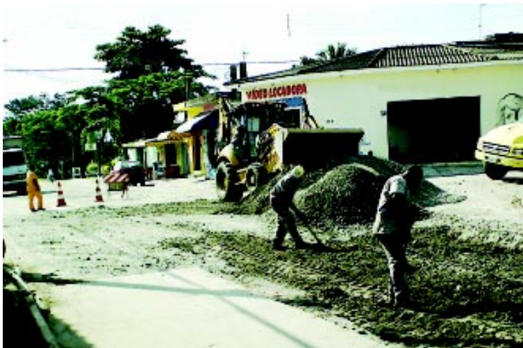
As obras do segundo trecho da avenida Flácides Ferreira estão sendo realizadas com recursos da Secretaria Estadual de Economia e Planejamento
