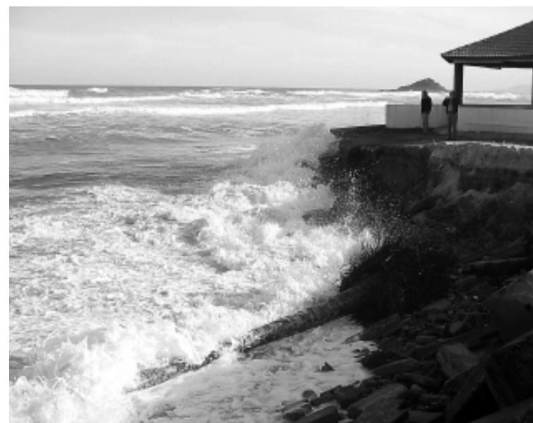
O objetivo final do projeto é a limpeza e restauração da encosta e recuperação do que foi destruído, além da dragagem do rio
