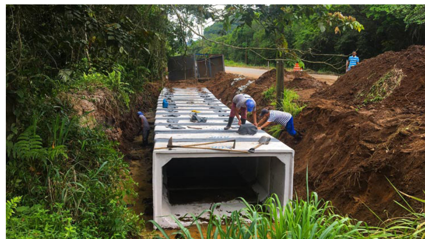
As equipes do Governo Municipal estão empenhadas para dar celeridade aos trabalhos para que a obra seja entregue o quanto antes
