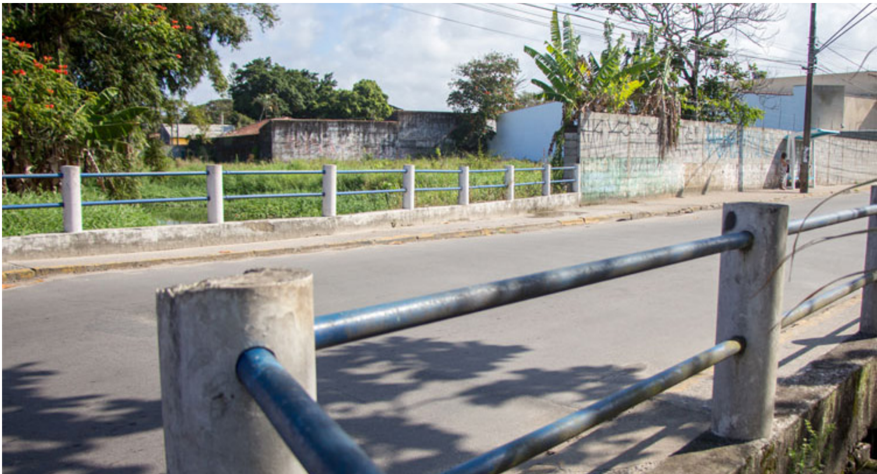
Na Rua dos Fundadores, a ponte possuirá 280 m 2 , e serão implantadas 45 aduelas de concreto, que são mais duráveis e aumentam a vazão do rio
